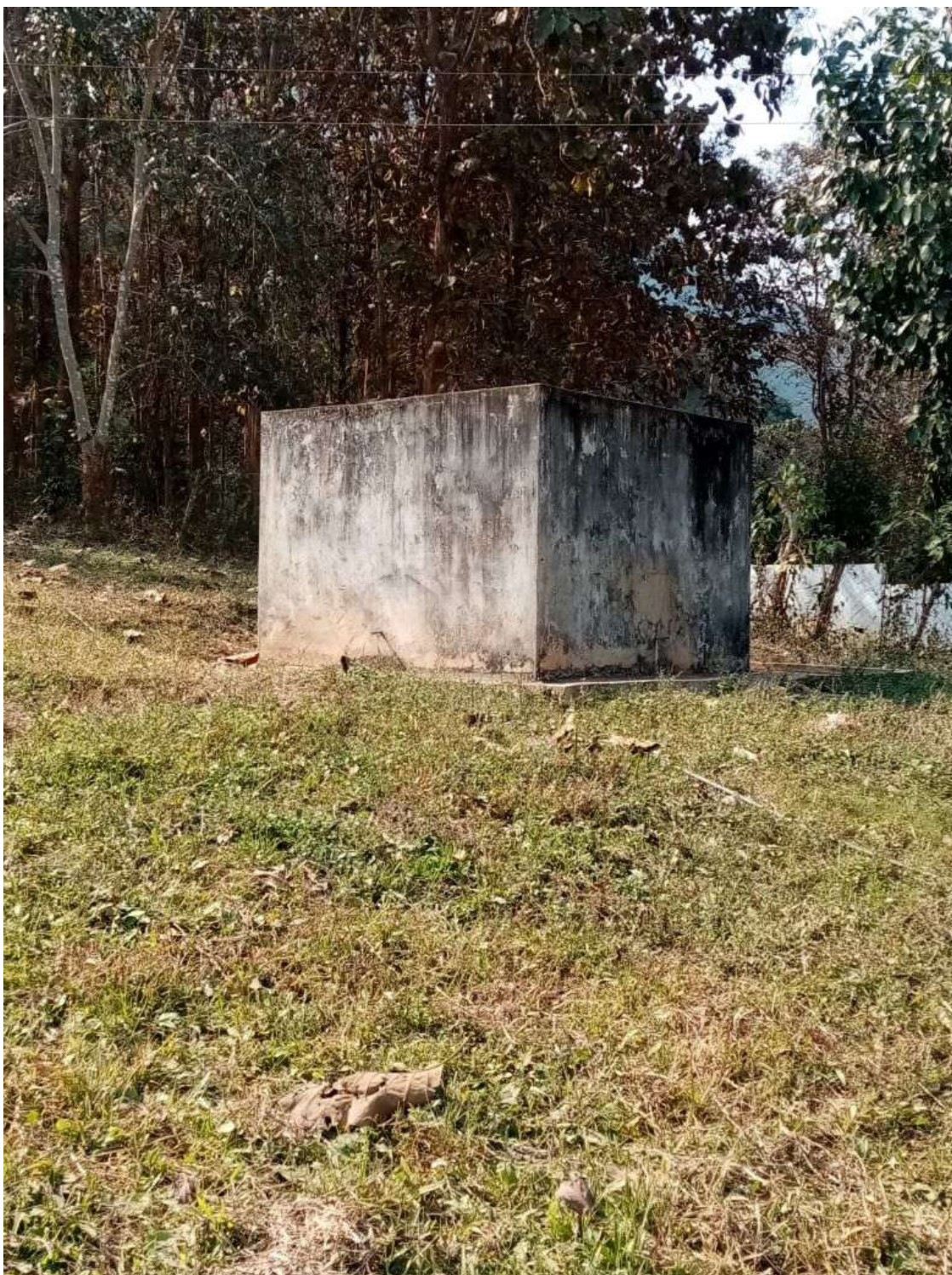
Le réservoir de 18 mètres cube situé dans la cours de l'école
