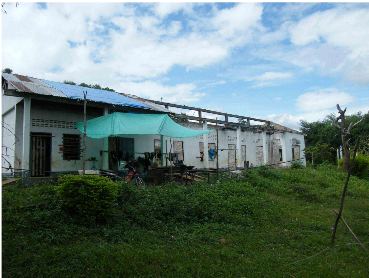
Le bâtiment de la maternelle qui a brûlé et n'est plus utilisable.
