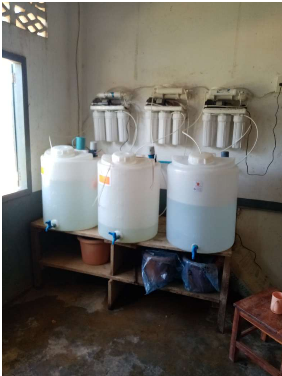
Le troisième filtre à eau a bien été installé (à droite) à côté des deux autres
